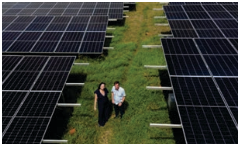
Usina fotovoltaica da Cooperativa de Energia Solar (COOPSOLAR), João Pessoa/PB.
